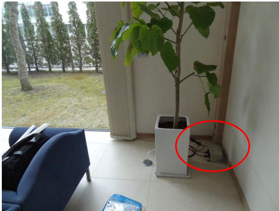
建物1階の地震計
